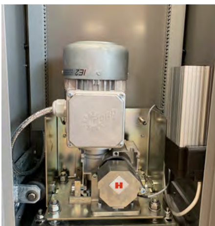
Motorisering Sleipner samt värme element.
