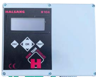
Schaltschrank mit einer Halsang H104 Steuerung und Frequenzmodulatoren
